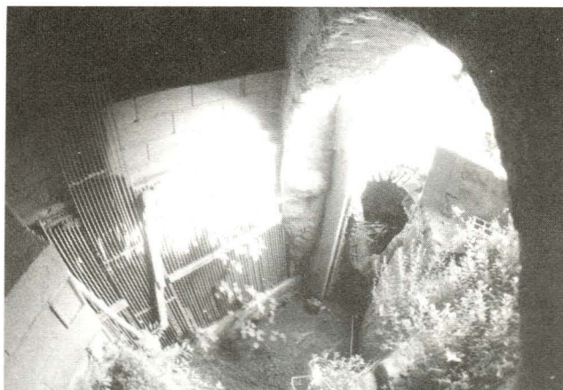
11 - Entrée des eaux. A droite, vanne de décharge
