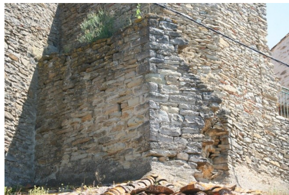
Fig. 31. Village castral, seconde enceinte. Vue extérieure de l'angle nord-ouest du périmètre (mur MR37). Cliché : F. Loppe, 2020.
