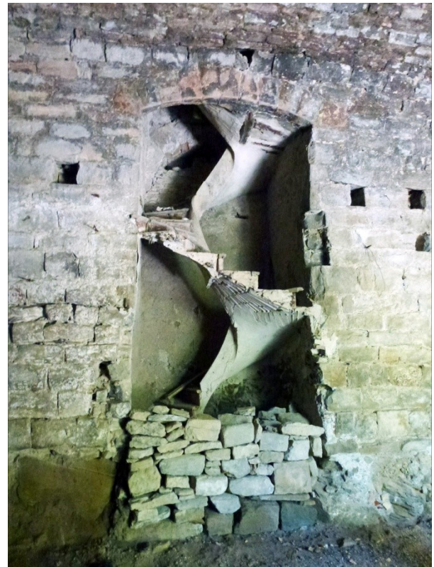
Fig. 22. Bâtiment III. Vue intérieure de la porte POR1 (mur MR3) débouchant dans la salle du rez-de-chaussée. Elle a été condamnée afin de mettre en place un escalier en vis lors de la transformation de l'édifice en maison à l'époque contemporaine. Cliché : F. Loppe, 2020.
