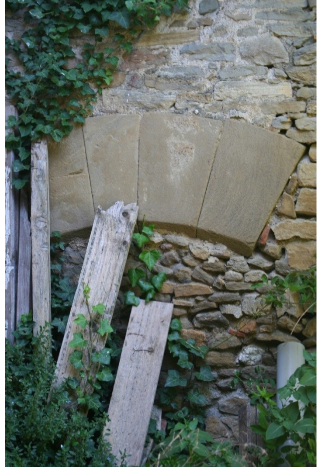
Fig. 34. Village castral, rue de la Taillanderie. Hôpital de ville (seconde moitié XIV e siècle). Vestige d'arcature conservé dans une maçonnerie. Cliché : F. Loppe, 2020.
