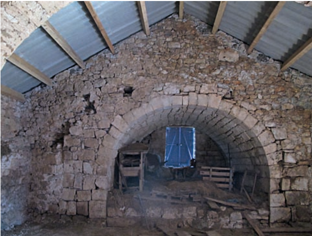
Fig. 18. Voûte du chevet de l'ancienne chapelle en élévation, depuis l'ouest (cliché A. Bergeret)
