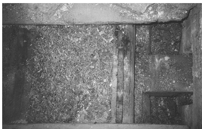
Fig. 10 : Vue d'un sondage par dessus un appui de poutre. On note les cales des planches sur les solives, la continuité des solives sur les poutres et surtout le bourrage des vides par de la paille.
